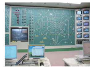
交通管制センター
